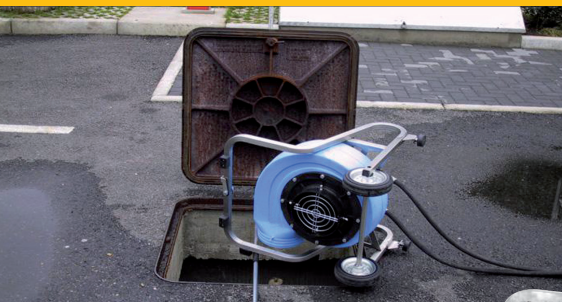
Ventilazione positiva e negativa
